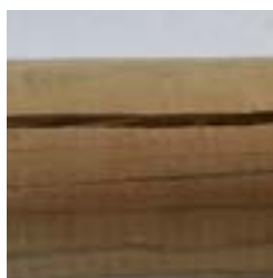
Cracks/Grietas/Fente/Risse/ Crepe/ Barsten/Fendas
